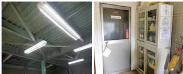
照明の飛散防止設備
