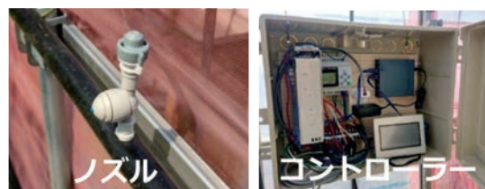
写真1 「ネット&ファンシステム」におけるノズル、コントローラーの様子
