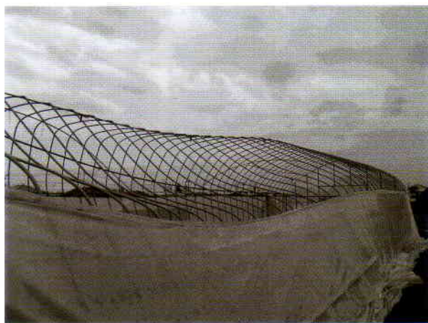
写真 強風の被害を受けた施設
