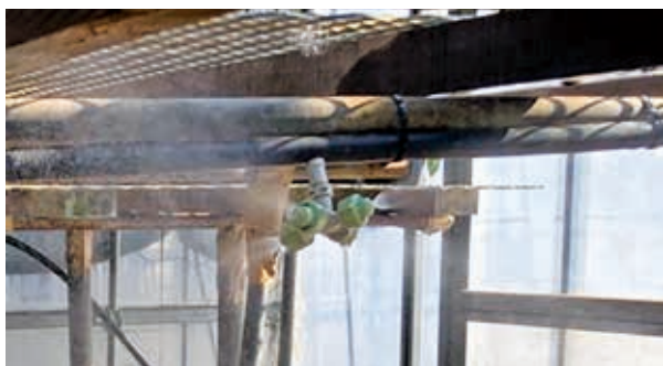
写真1 ベンチ下ミスト冷房の設置状況
